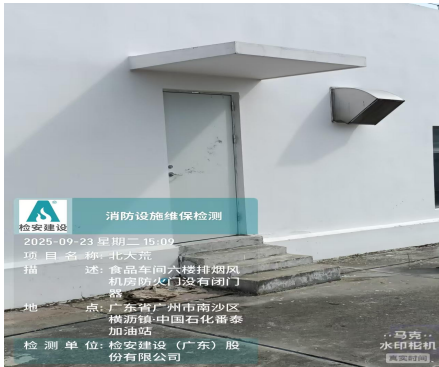
163. 排烟风机房防火门未安装闭门器。
