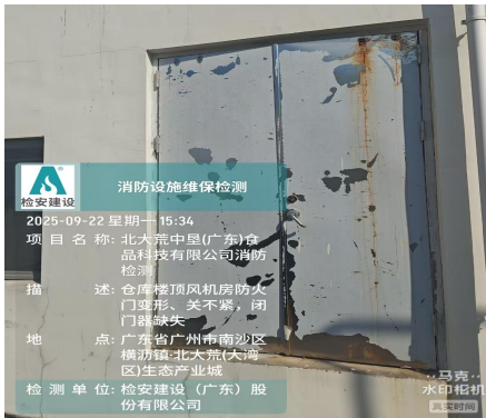
69. 送风机房防火门闭门器缺失。
