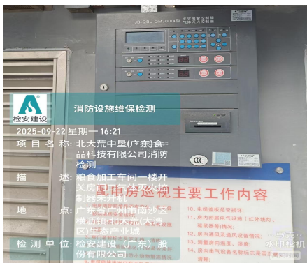
77. 开关房门口气体灭火控制器未开机。
