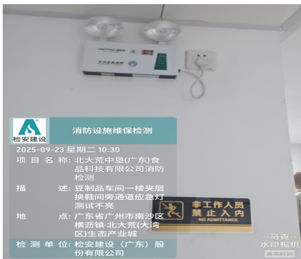
141. 换鞋间旁通道应急灯测试不亮。
