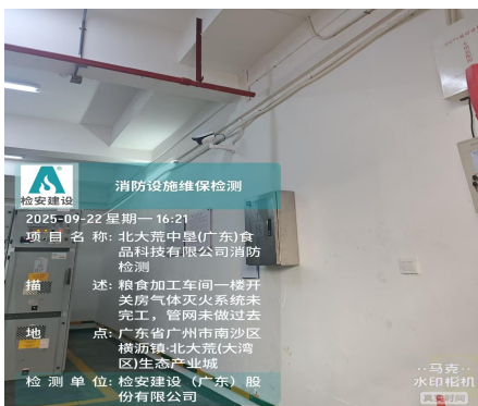
78. 开关房气体灭火系统未完工，管网未做过去。
